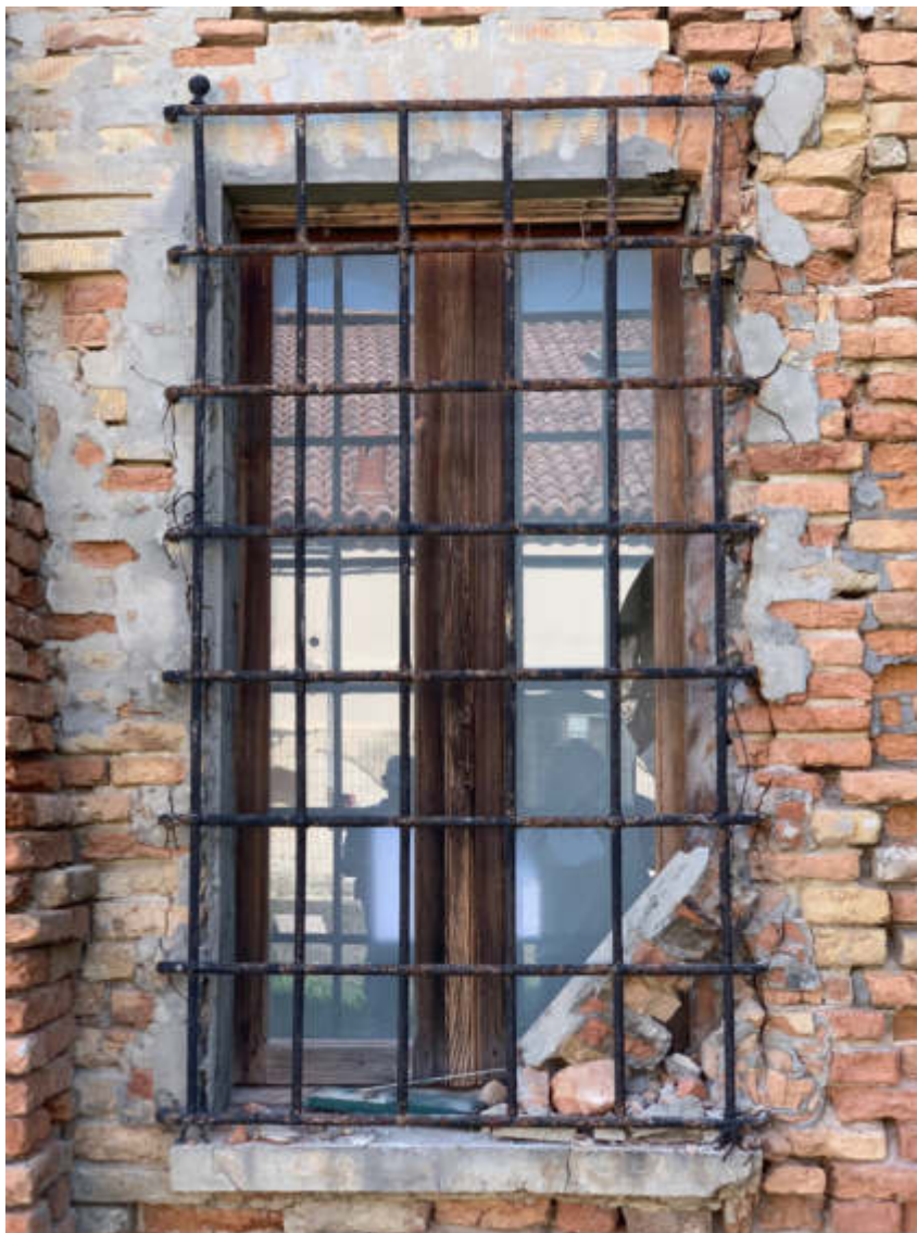
Finestra in cui è avvenuto il crollo della spalletta
