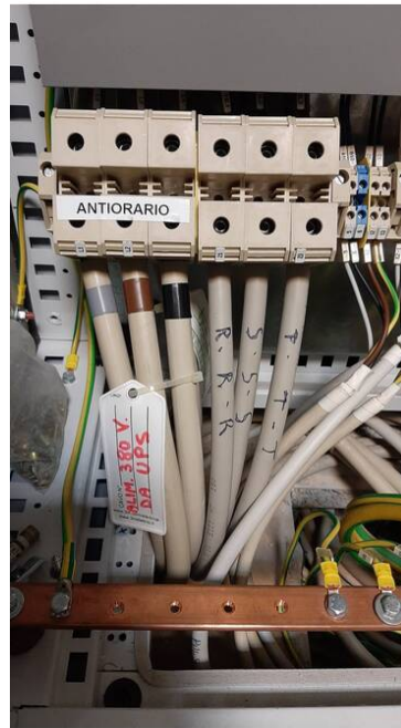
QUADRO PET 4 linea da UPS
