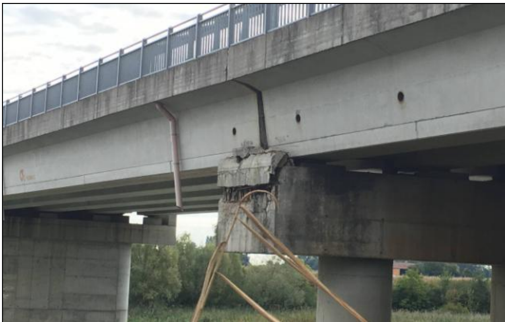
Danneggiamento della trave-pulvino
