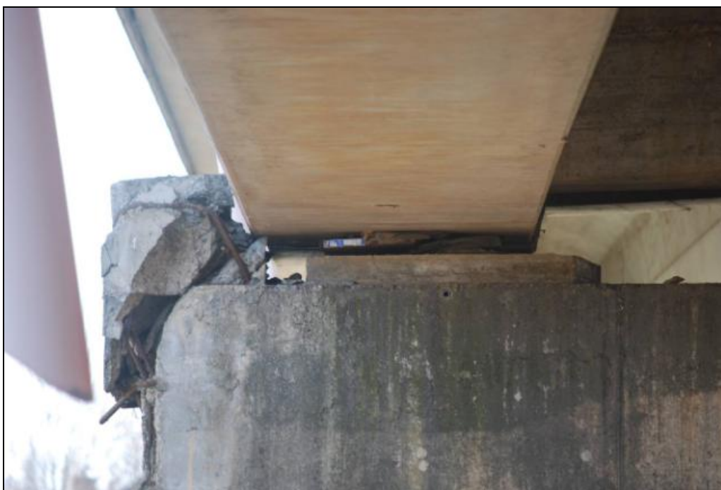
Danneggiamento degli appoggi in seguito alla traslazione degli impalcati
