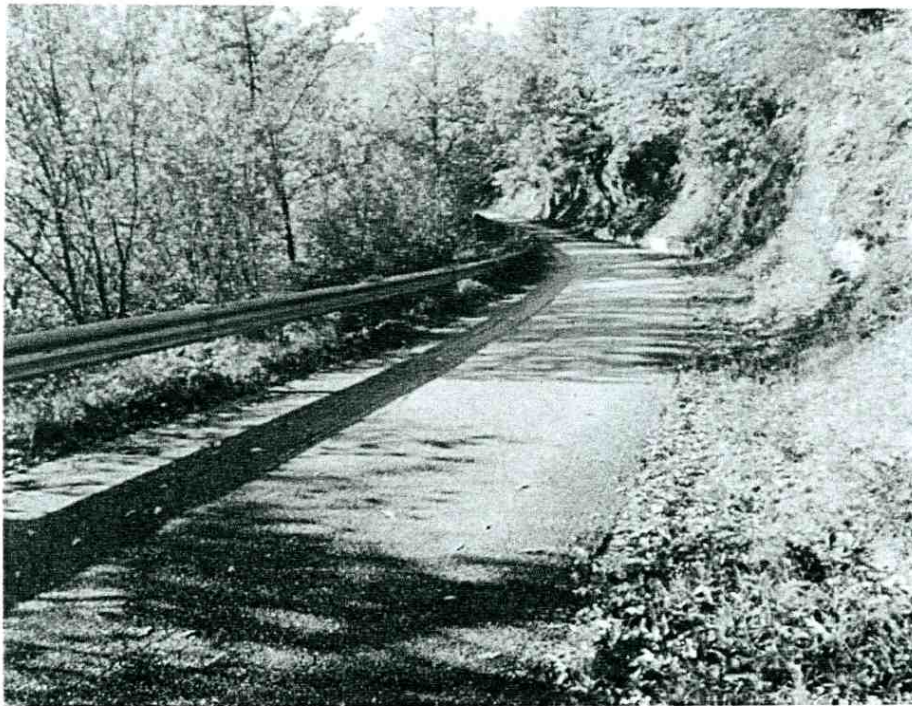
FRANA 2 CON SEDE STRADALE DISCONNESSA VERSO VALLE
