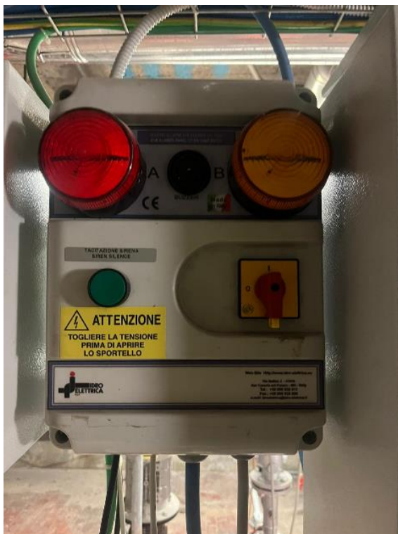
Quadro di allarme pompe antincendio
