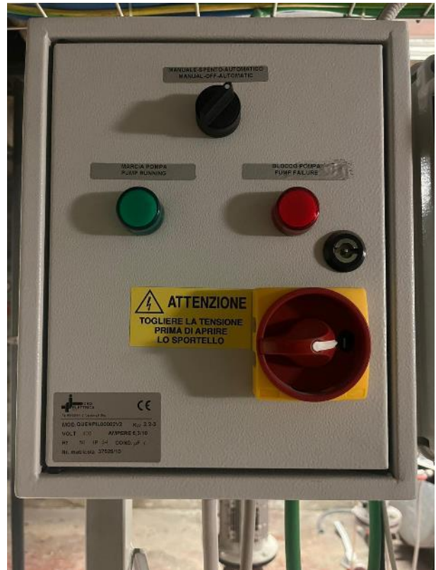
Quadro di funzionamento pompe antincendio
