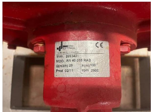
Matricola e dati elettropompa principale
