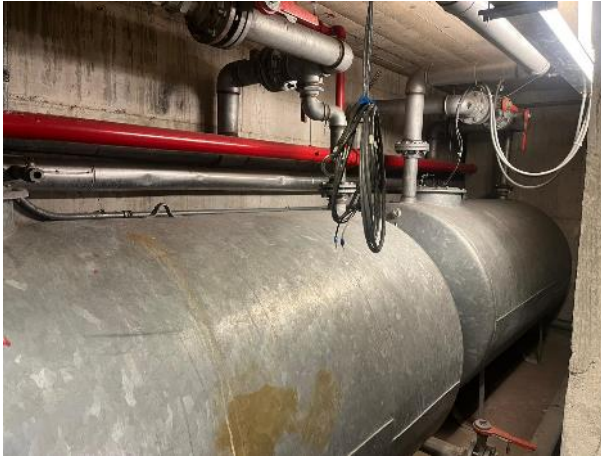
Serbatoi metallici di accumulo idrico
