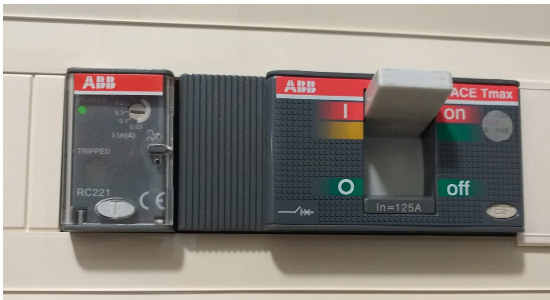
Fig. 5 . Interruttore a valle Picker nel quadro “BB-Q08 A” (locale L054)
