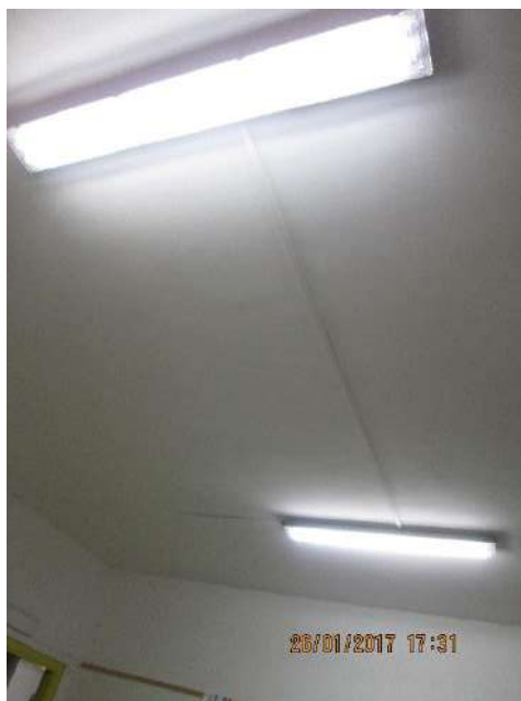
Figura 12 - Particolare corpi illuminanti
