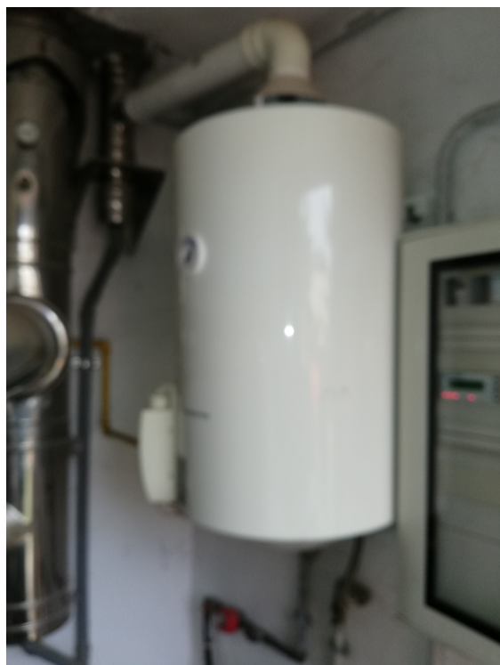
Centrale termica mensa - bollitore
