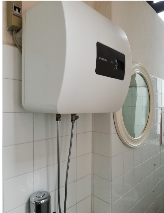
Boiler elettrico per ACS - scuola
