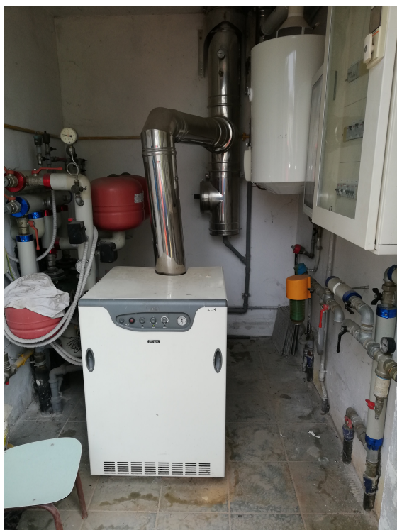
Centrale termica mensa – generatore di calore
