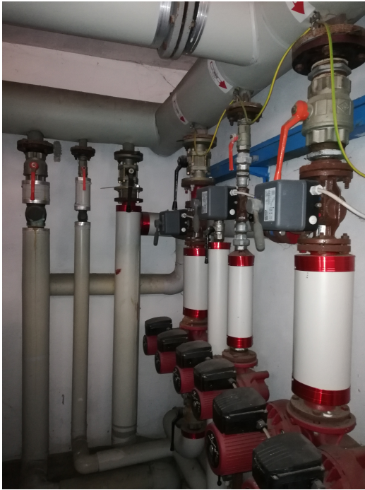
Centrale termica scuola – tubazioni di mandata
