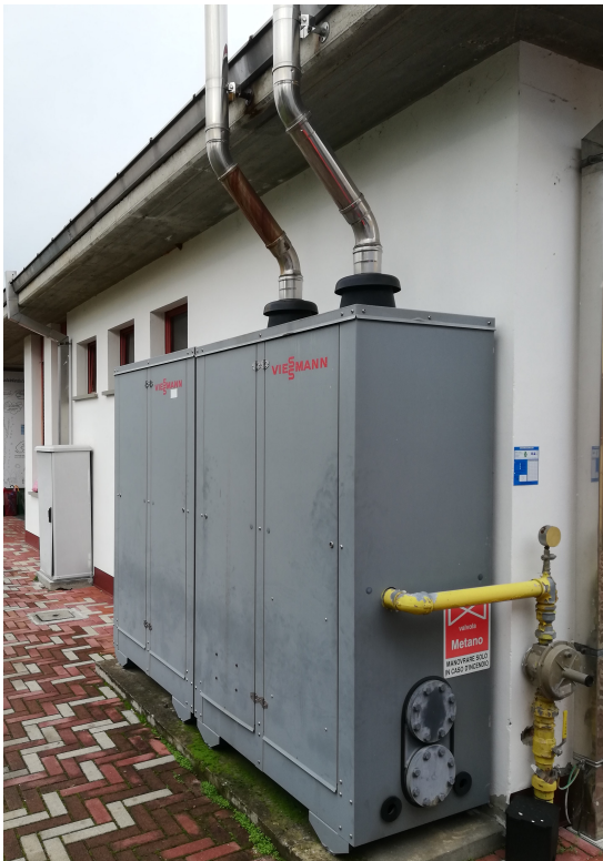
Centrale termica esterna
