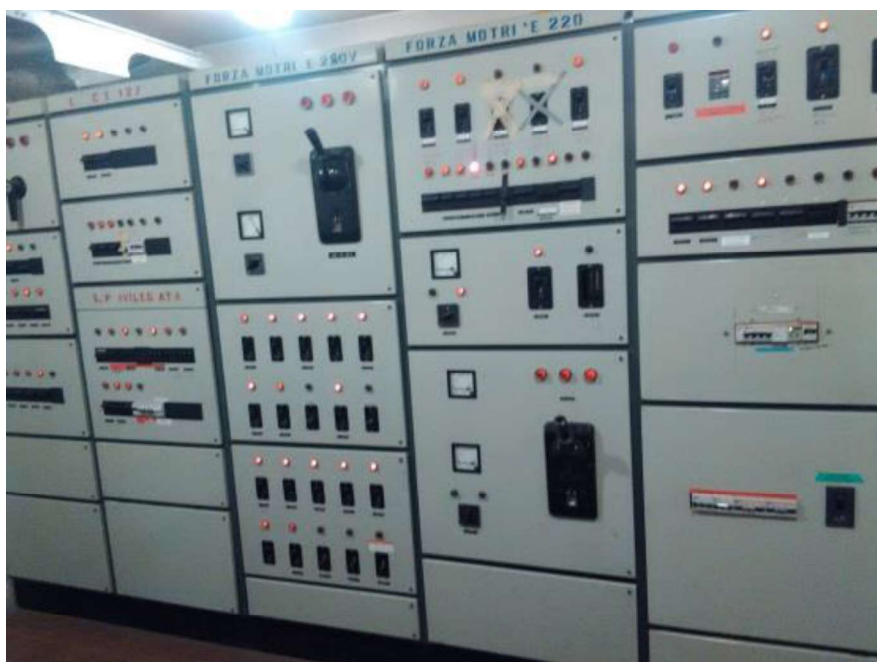
Figura 8: Quadro elettrico originario del padiglione 15
