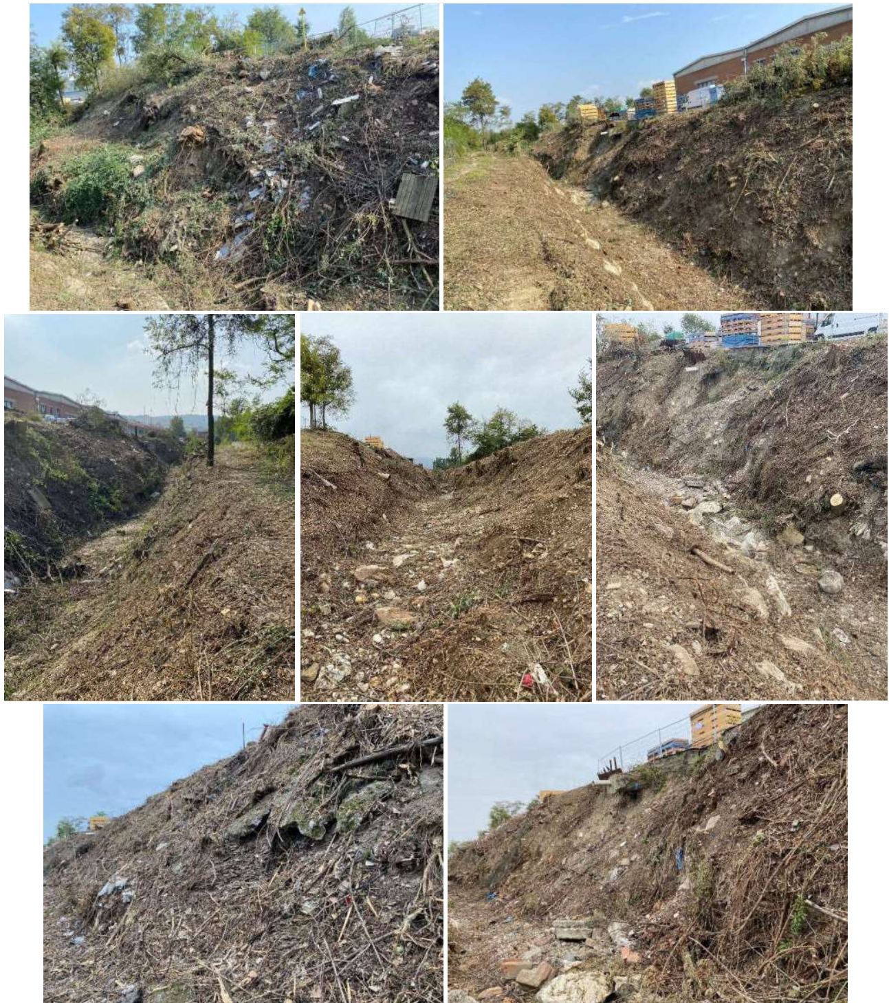
Figura 13 – Riprese fotografiche delle ripide sponde che contraddistinguono il tratto di monte del Rio Medici; a lato della sponda sinistra visibile il sentiero che costeggia il Rio; sono inoltre e massicciate poste a protezione delle rive in parte franate sul fondo del corso d’acqua.
