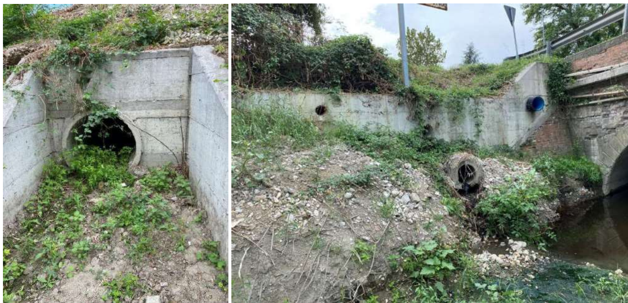
Figura 19 – Alcuni degli scarichi rilevati sulla sponda destra del corso d'acqua (sopra) e nei primi metri a monte sito rispettivamente sulla sponda destra e sinistra, inseriti in appositi manufatti in cemento di protezione (sotto)
