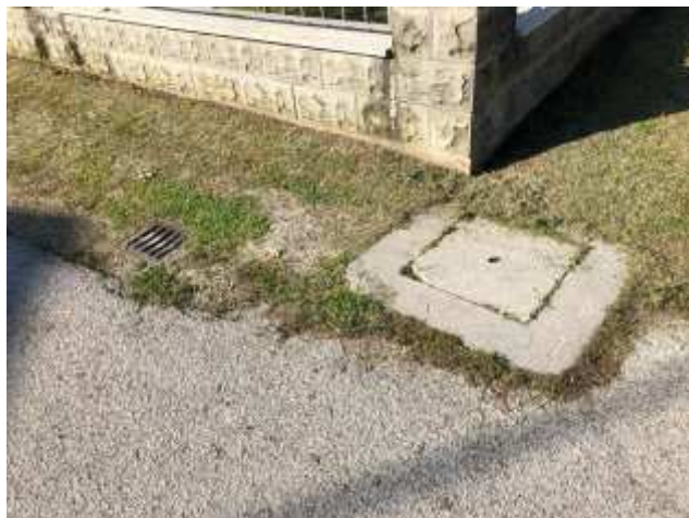
Foto 30 – Via Divisione Cremona – Scavo della banchina, sostituzione maschere pozzetti con nuove in ghisa carrabile, realizzazione di sottofondo, formazione pendenze e messa in quota pozzetti, tappeto di usura in conglomerato bituminoso.
