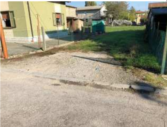
Foto 7 – Via Argelli, scavo del terreno, realizzazione di cordolo spessore cm 8 sul confine di proprietà, realizzazione di soletta in c.a. e tappeto di usura in conglomerato bituminoso
