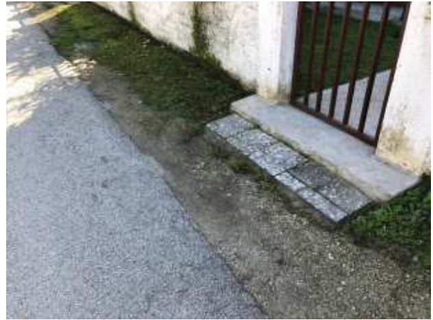
Foto 34 – Via Divisione Cremona – Scavo banchine, nuovo sottofondo e formazione pendenze, fresatura asfalto esistente e tappeto di usura in conglomerato bituminoso.
