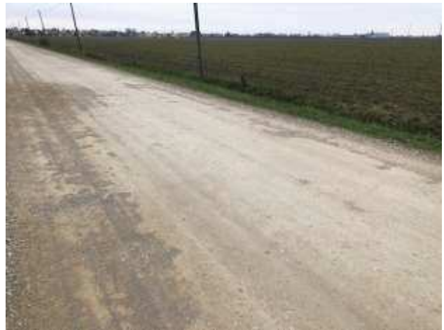
Foto 84 – Via Rondelli. Secondo tratto di intervento verso il fiume. Scavo, posa di nuovo stabilizzato, binder e tappeto di usura.
