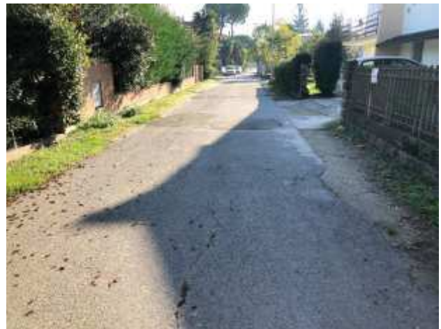
Foto 24 – Via Divisione Cremona – Scavo, realizzazione di sottofondo, formazione pendenze e tappeto di usura in conglomerato cementizio.
