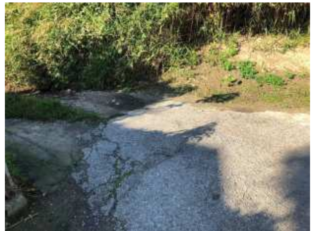
Foto 16 – Via Argelli – Inserimento di cordolo spessore 8 cm su confine di proprietà e contro l'argine del fiume come chiusura dell'asfalto
