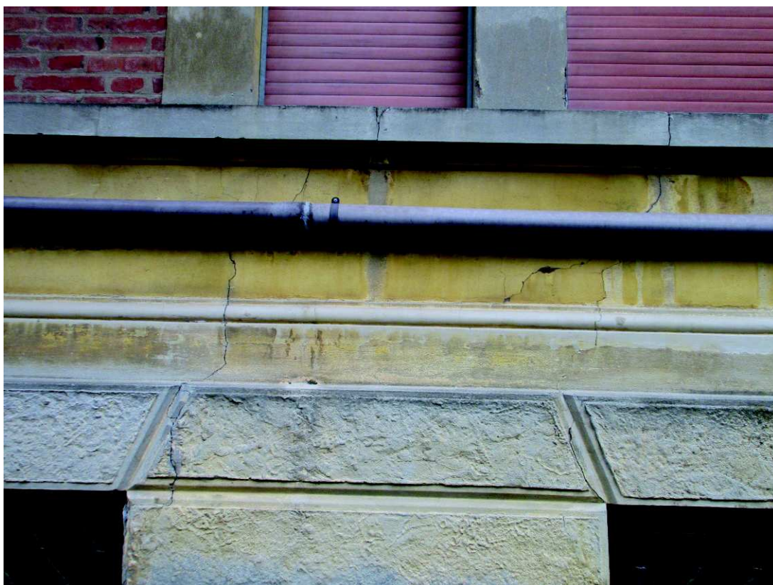
FOTO 25: fessure nell'architrave della finestra
