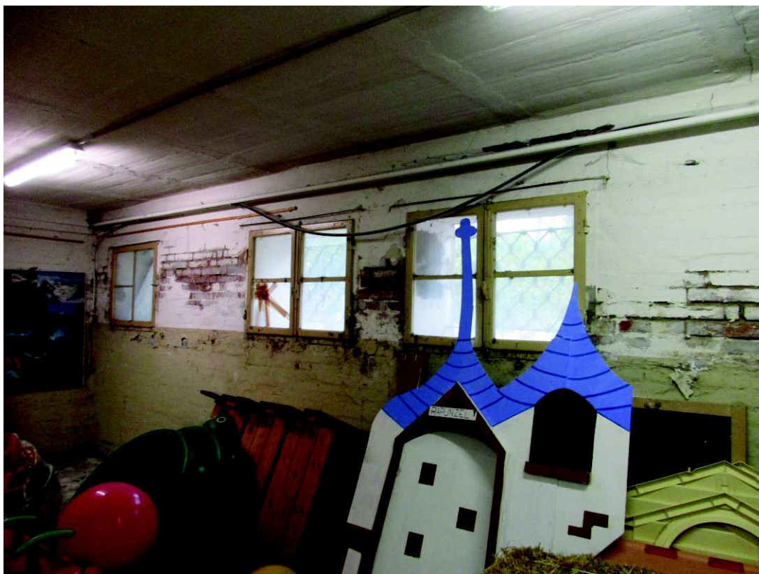
FOTO 32: infiltrazioni e/o umidità da risalita al piano interrato
