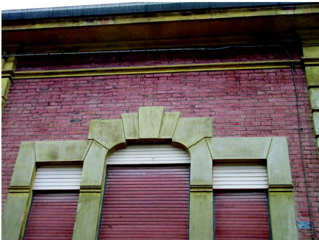
FOTO 19: fessure nell'architrave della finestra
