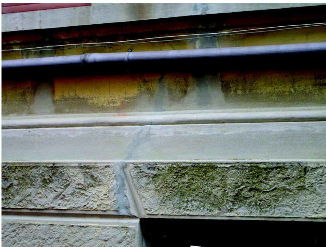
FOTO 17: fessura nell'architrave della finestra stuccata recentemente
