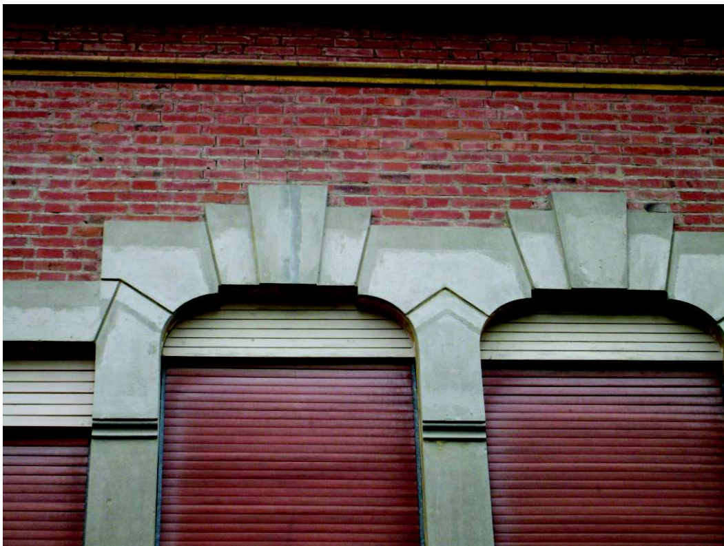
FOTO 15: fessura nell'architrave della finestra stuccata recentemente
