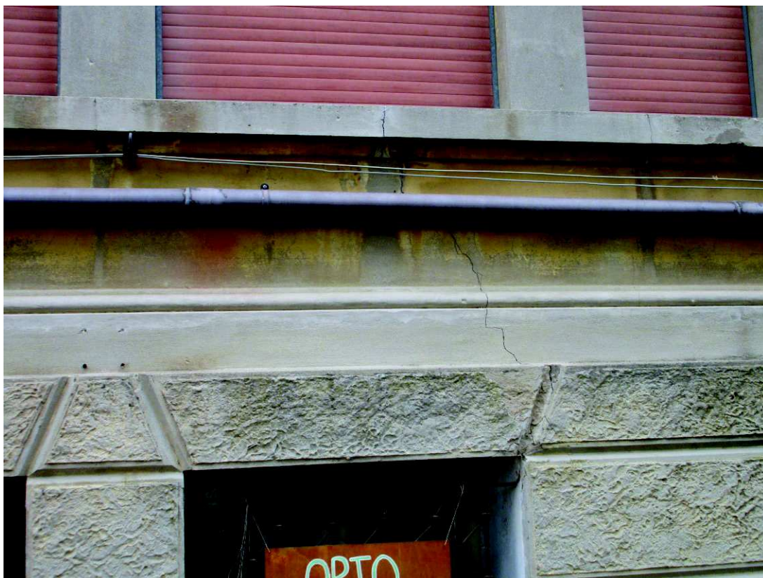
FOTO 16: fessura nell'architrave della finestra
