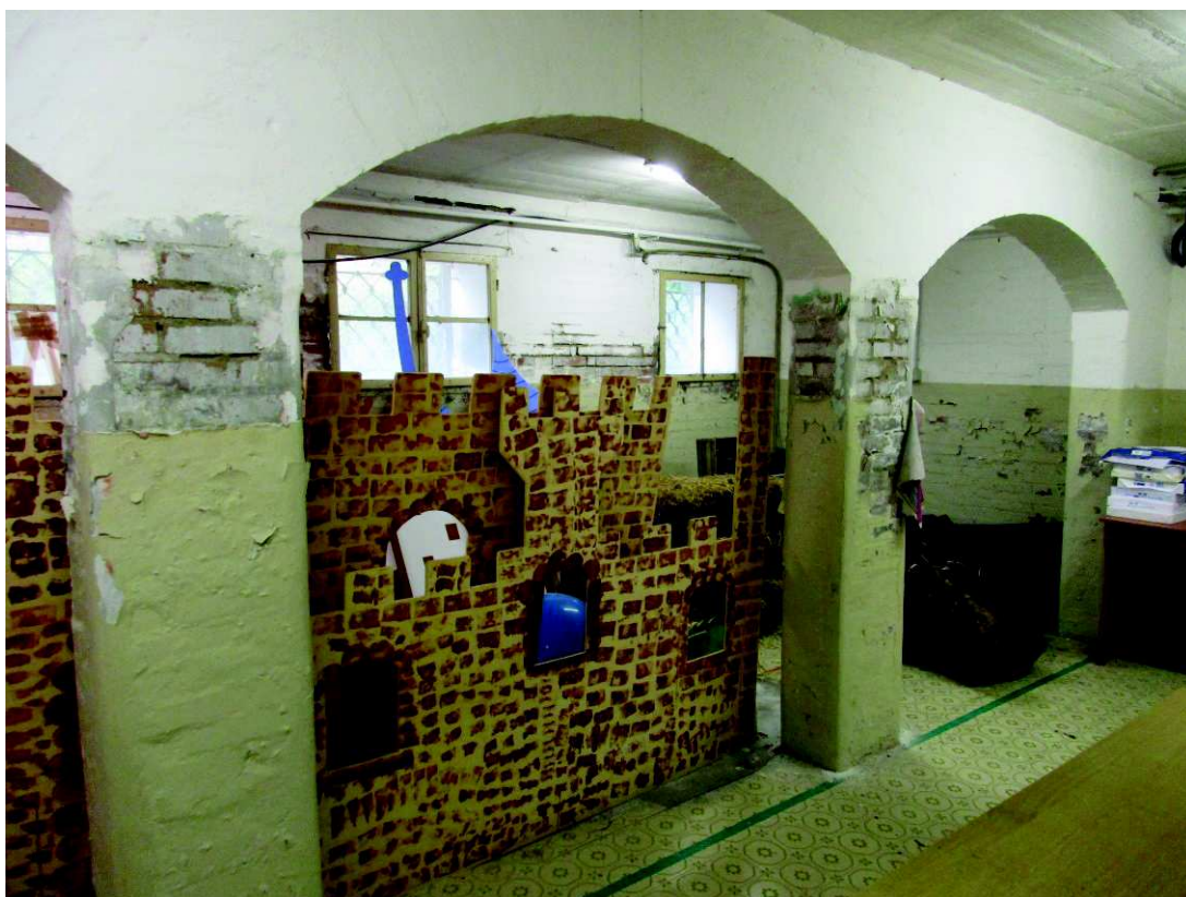
FOTO 33: infiltrazioni e/o umidità da risalita al piano interrato
